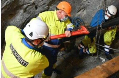
Installation von Packern zur Isolierung der Stimulationsintervalle im Bohrloch ST2 im Bedretto-Labor der ETH Zürich. Die Arbeiten wurden unter der Leitung von Geo-Energie Suisse durchgeführt. © Geo-Energie Suisse
