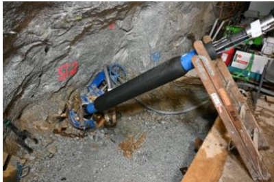
Installation von Packern zur Isolierung der Stimulationsintervalle im Bohrloch ST2 im Bedretto-Labor der ETH Zürich. Die Arbeiten wurden unter der Leitung von Geo-Energie Suisse durchgeführt. © Geo-Energie Suisse
