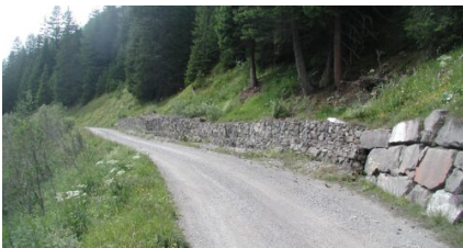
Trassenabschnitt mit Hangkriechen.
